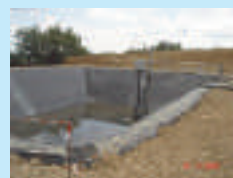
Bassin d'épuration - Il traitera les effluents issus de la cuverie
