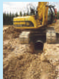
Installation du collecteur d'eau pluviale en bout de fossé. Il longe la route qui monte à la cuverie
